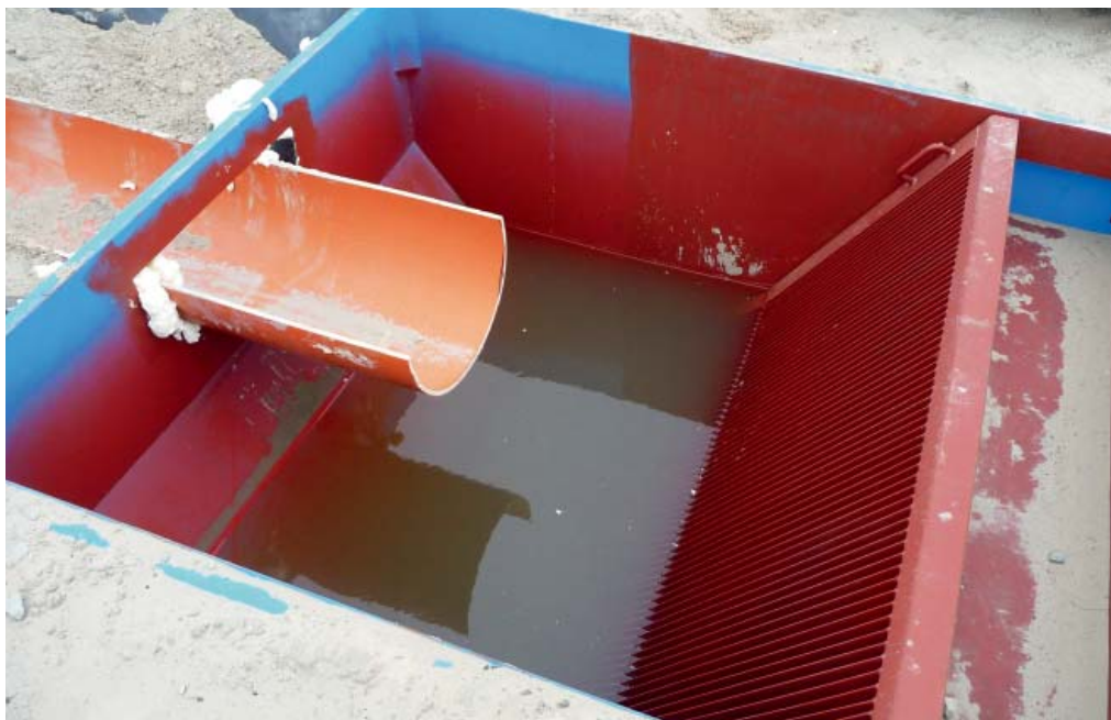
Fot. 1. | Śluza przeciwolejowa
